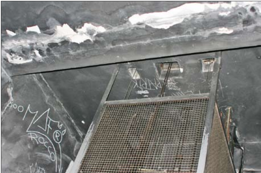
Najvyššie poschodie je ako undergroundový klub – čierne steny sú však výsledkom požiaru zo zapálenej kabíny výtahu.
